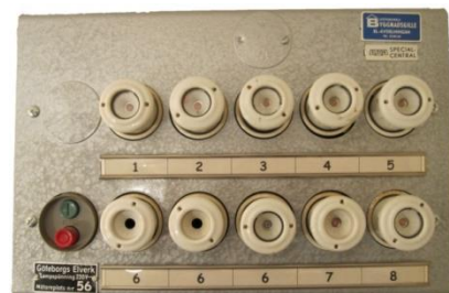
Denna central är från sextiotalet och har så kallade porslins-säkringar (proppar)
