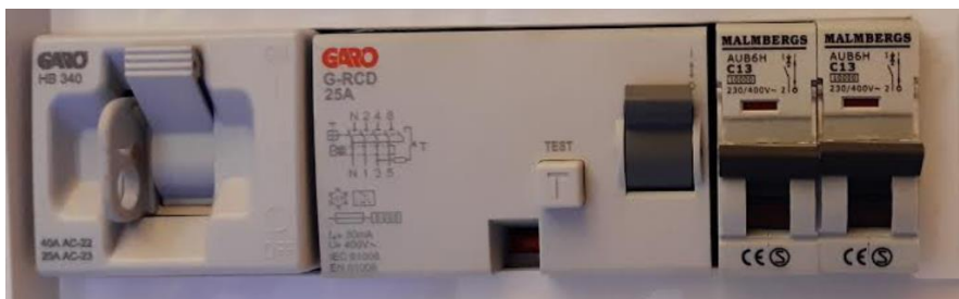
Ovan visas en modern elcentral med huvud- jordfelsbrytare och två stycken automatsäkringar
